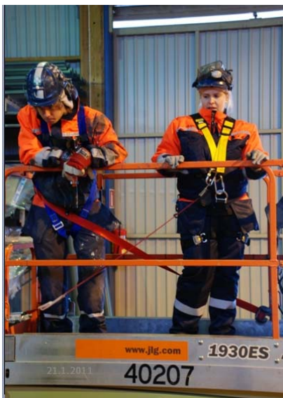
Kuva 7. Myös saksinostin on henkilönostin ja siellä työskenneltäessä on käytettävä putoamissuojaimia. Myös nostimen vakavuus ja alustan kantavuus on varmistettava.
