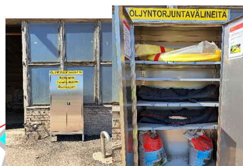
Korjaamolla öljyntorjuntakaappi, jossa viemärinsulkumattoja sekä imeytysainetta
